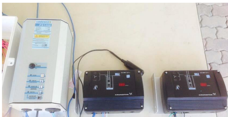
รูปที่ 3 เครื่องแปลงกระแสไฟฟ้า
